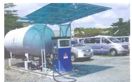
Trạm nạp LPG tại TP. HCM (Autogas)
